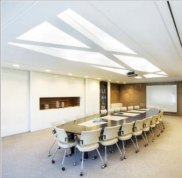
Sala de reuniones (Turquía) - Realización: TTI Elektrik Elektronik
